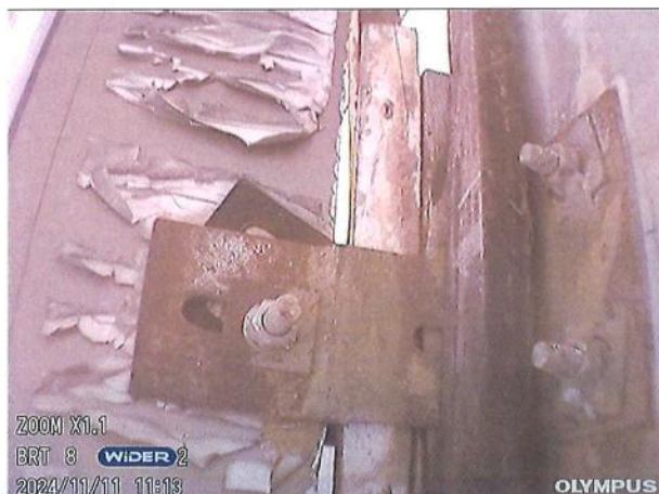
图 5-26 立柱与主体连接钢转接件及后置钢板锈蚀 1
