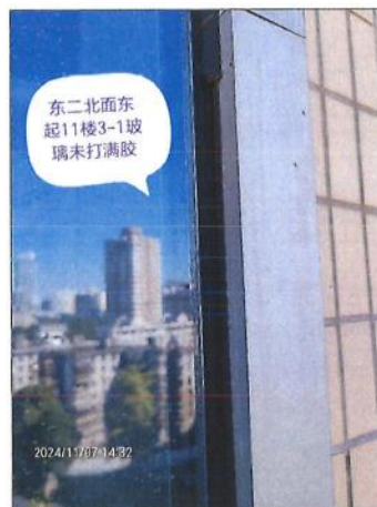
图 10-4 玻璃面板漏注密封胶
