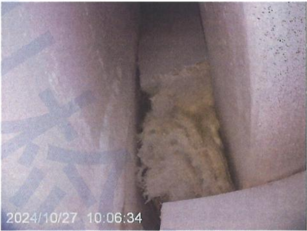
图 6-22 职工餐厅防火棉检查情况 2
