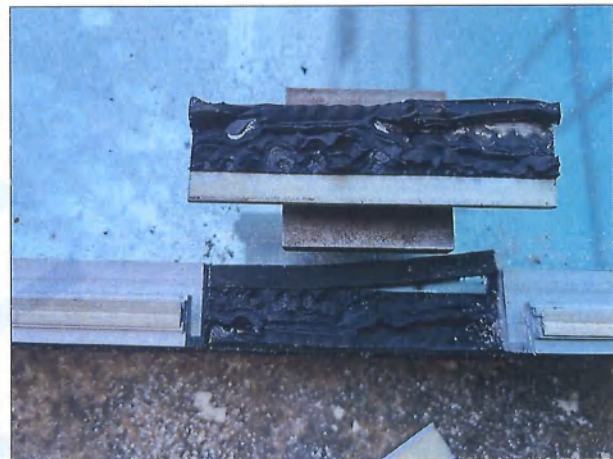
图 4-44 东 3 号楼结构胶内聚破坏
