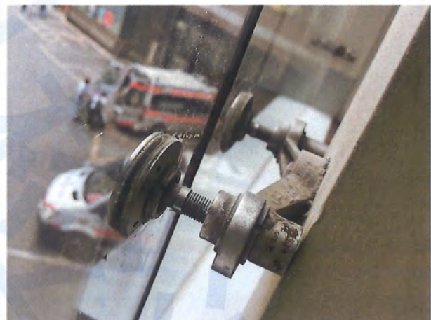
图6-8 门诊住院大楼2F连廊爪件检查情况
