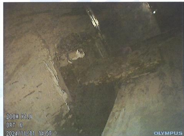
图 5-27 立柱与主体连接钢转接件及后置钢板锈蚀 2
