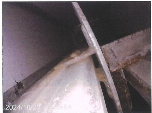
图 7-24 立柱与主体连接钢架锈蚀
