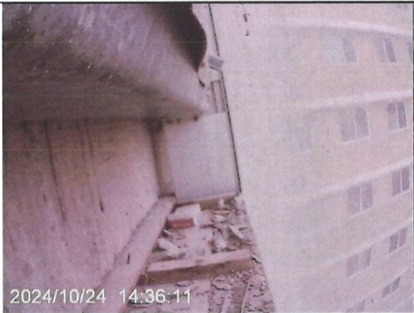
图 4-53 东 3 号楼防火板封堵不严密 1
