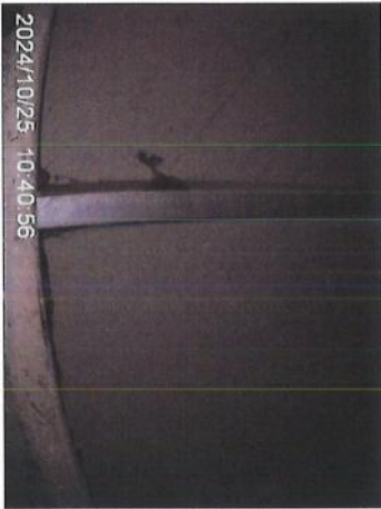
图7-16 面板内侧检查情况3
