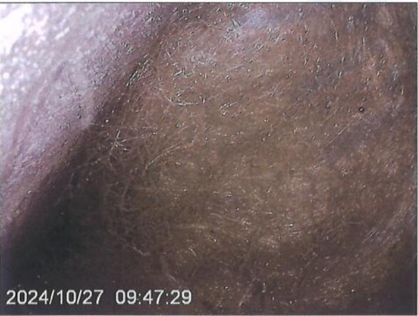
图 6-21 职工餐厅防火棉检查情况
