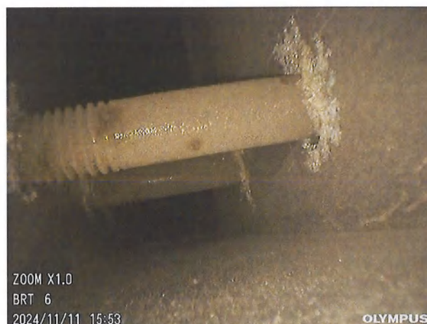
图 5-13 连接螺栓检查情况
