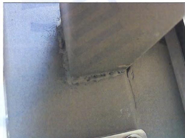
图 6-10 职工餐厅支承构件连接焊缝存在气孔
