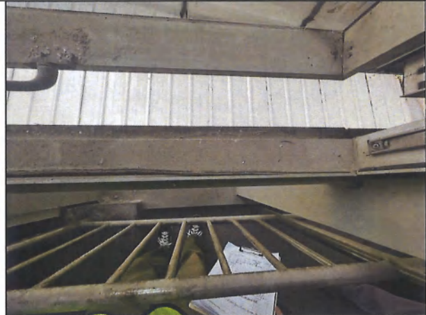
图 4-46 防水胶条脱落
