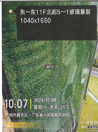
图 10-1 玻璃面板开裂
