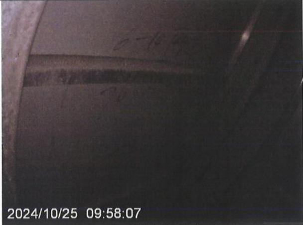
图 7-14 面板内侧检查情况 1
