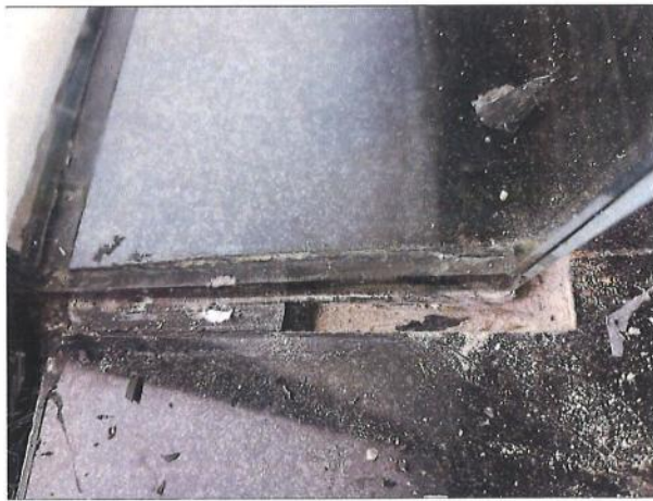
图 4-21 玻璃肋底部检查情况
